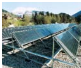
2001: Start der Solarthermie mit dem System WTS-F.
